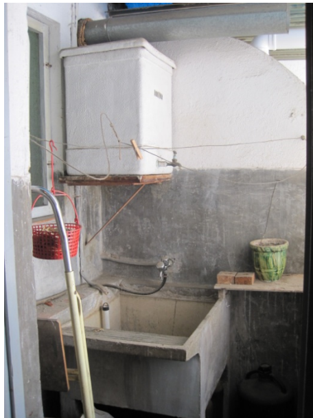
Estat previ a les obres de rehabilitació
