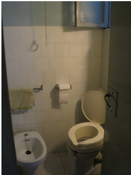
Estat previ a les obres de rehabilitació
