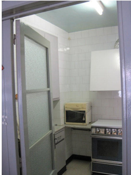
Estat previ a les obres de rehabilitació
